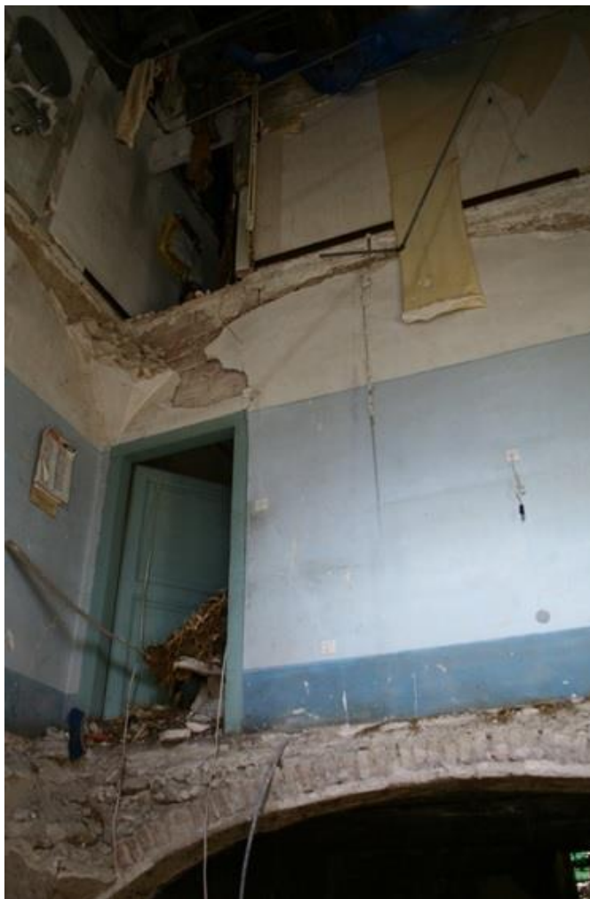
Scarso ammorsamento fra solai e pareti
